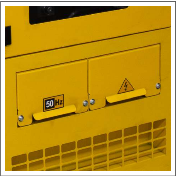
Bornera de conexión
